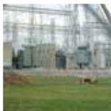
Manutenção de subestações elétricas
