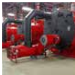
Instalação e/ou manutenção de caldeiras
