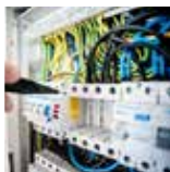
Instalações elétricas de baixa tensão (redes, quadro, medição, etc)
